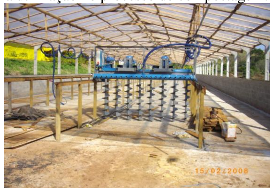
Figura1 – Instalação pronta para compostagem.
