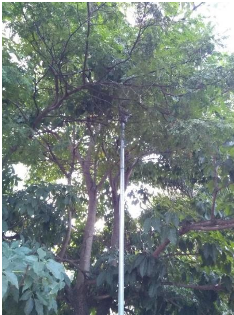
Figura 4 - Luminária encoberta por folhas em poste de iluminação pública.
