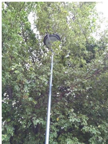
Figura 5 - Excesso de vegetação ao redor do ponto de luz reduz a área de iluminação.
